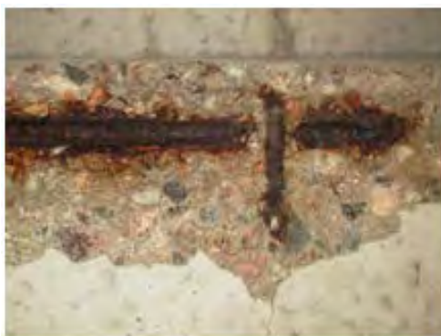
Exempel på skadad balkong. OBS! Annat objekt!
